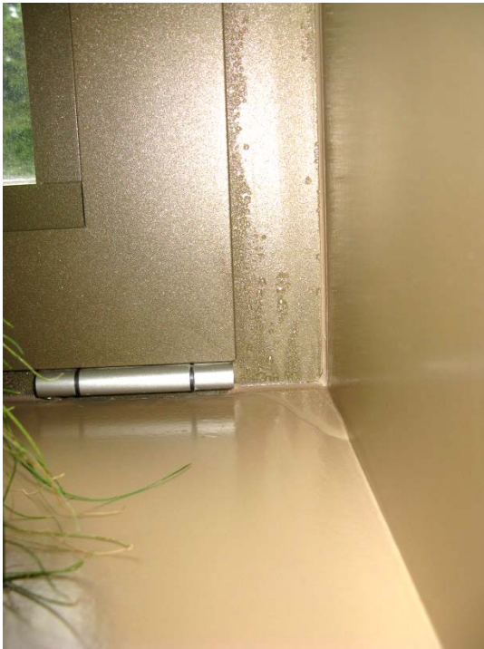
Bild 1: Fensterrahmenecke unten Kondensatbildung an der Rahmenoberfläche.
