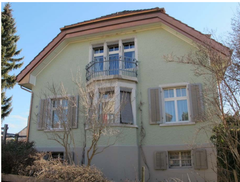
Bild1: Wohnhauses um 1900 erstellt. Beispiel eines Schadenfalls.
