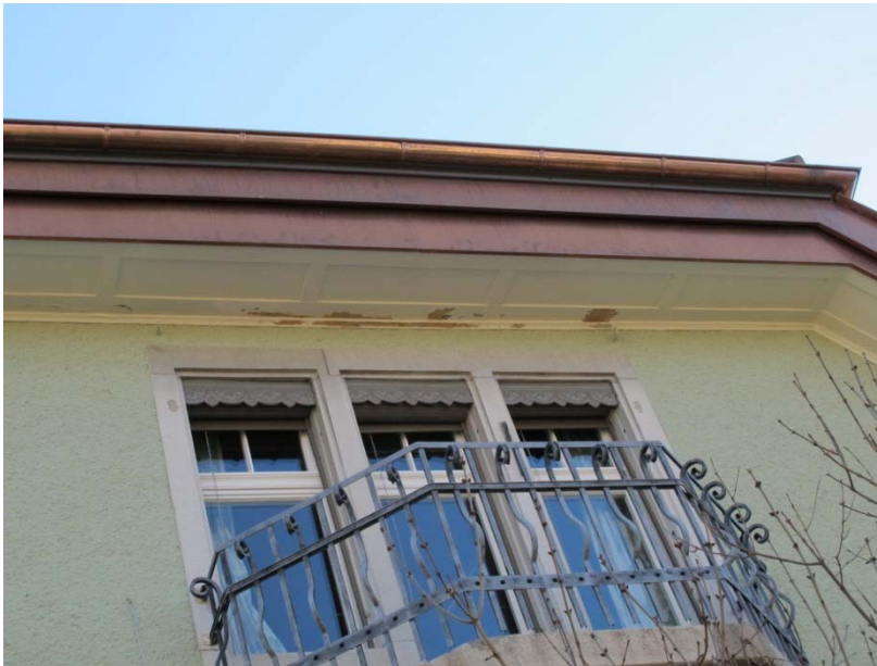
Bild 2: Farbablösungen an der Dachuntersicht nach der Instandstellung des Dachs.
