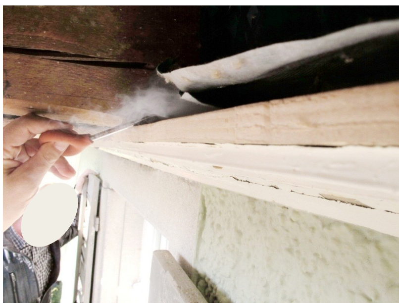
Bild 5: Nachweis ausströmender Raumluft bei Überdruck im Innern mit Strömungsprüfröhrchen.
