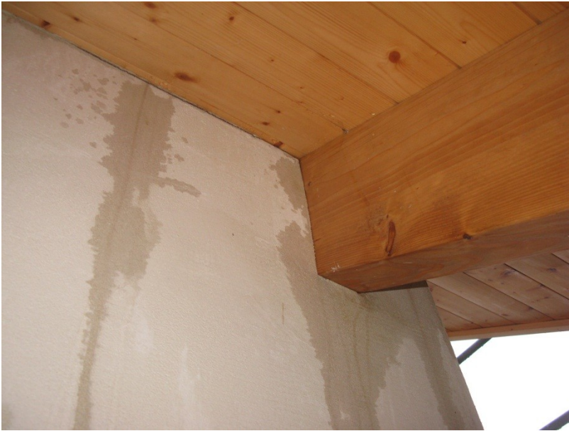
Bild 7: Wasser von der Vordachunterseite an der Aussenwärmedämmung ablaufendes Wasser.
