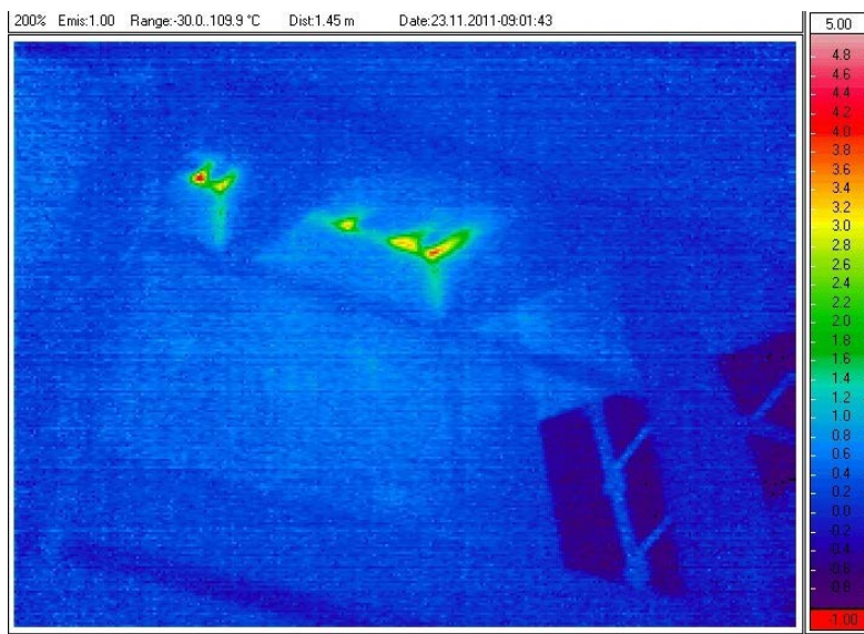
Bild 8: Infrarotaufnahme des Bereichs in Bild 7. Warmluftaustritte unter dem Vordach.
