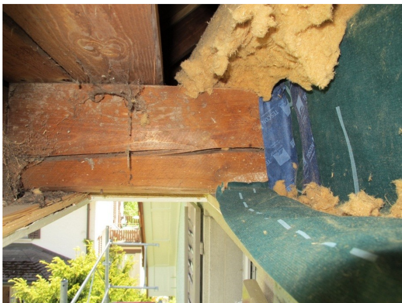
Bild 4: Einsicht in die Vordachkonstruktion nach dem Öffnen der Vordachschalung. Luftdichtungsfolie zwischen den, nach aussen durchlaufenden, Deckenbalken bis auf das Mauerwerk hinunter geführt, jedoch nicht am Mauerwerk angeschlossen.
